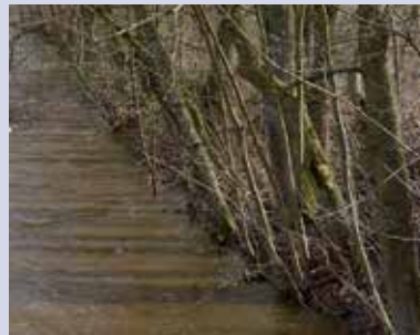
Abb. 5: Grünverrohrung durch zu eng gesetzte Bäume.
