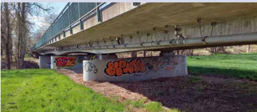
Abb 2: Sammlung des Oberflächenwassers einer Flussbrücke und Einleitung in die Flussaue Foto: Koop/Becker
