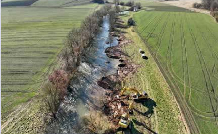
Durch die Abflachung der Uferbereiche wird die Dynamik des Flusses gefördert Foto: AV Hassia Fulda brück e. V.
