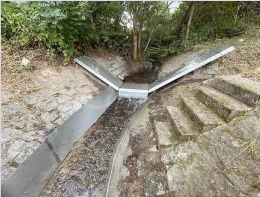
Abbildung 3: Sperre auf Stützschwelle Foto: R. H.
