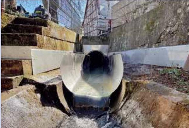
Abbildung 4: Sperre in einem Feuerwehr-Stau in Verdolung, Bj. 2023 Foto: R. Hennings
