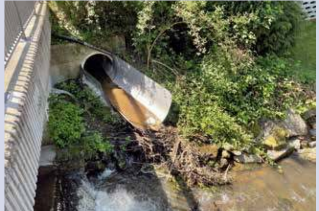
Abbildung 5: Treibgut aus der Verdolung nach Hochwasser stellt eine Übersteigmöglichkeit dar, die umgehend entfernt werden muss Foto: R. H.
