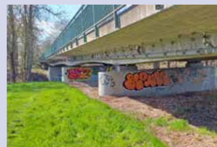
Amperbrücke einer Staatsstraße im Kreis Freising: Hier wird das Regenwasser in größerem Abstand vom Ufer, aber noch innerhalb des Hochwasserdamms in das Ufersubstrat geleitet. Fotos: Dr. Udo Becker
