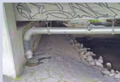
A9, eine der stärksten befahrenen Autobahnen in Deutschland, Landkreis Freising/Bayern. Das Regenwasser wird am Ufer der Amper direkt in die Steinpackung geleitet.
